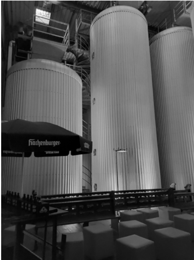
In dieser Halle wird die CO 2 -Rückgewinnungsanlage der Firma Wellmann, Halle (Westfalen), installiert.
